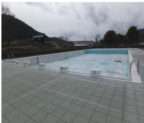
【プール水槽劣化】
