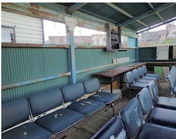
【ダッグアウト劣化】
