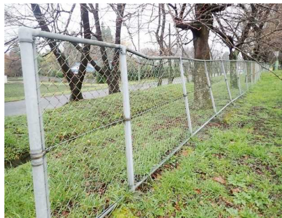
【フェンス傾き等劣化】
