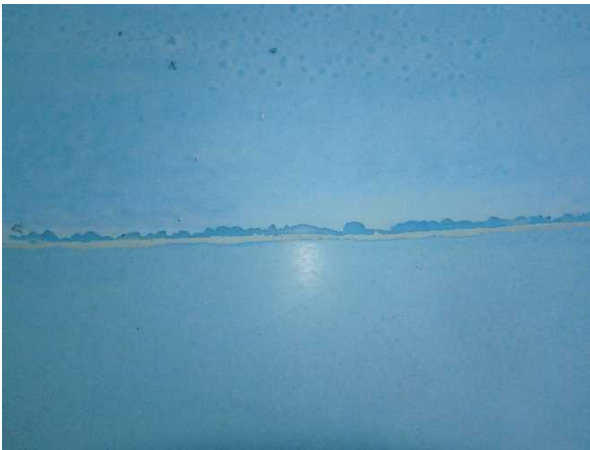
【屋内プール水槽剥がれ等劣化】
