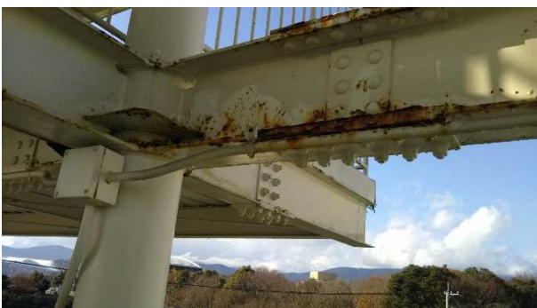
【屋外プールウォータースライダー劣化（階段部）①】
