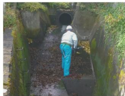
水道施設の保全 取水場に枯葉や流木が詰まった場合は 現場に駆け付け、手作業で除去
