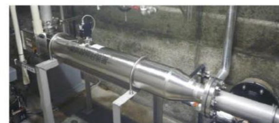
紫外線照射装置(猪之頭第2配水池)
