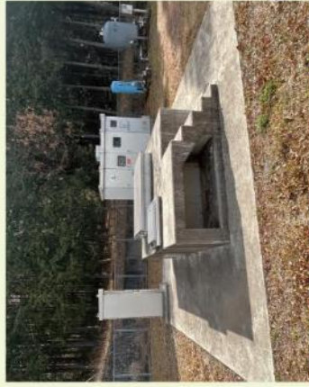
にしやまそうすい しょう 西山送水ポンプ場
