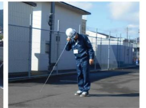
漏水の調査 音聴調査による漏水箇所の特定
