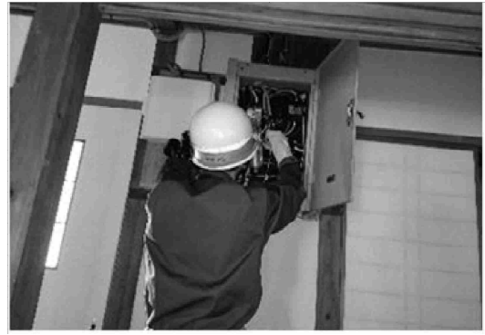
写真 17 漏電検査（西山本門寺）
