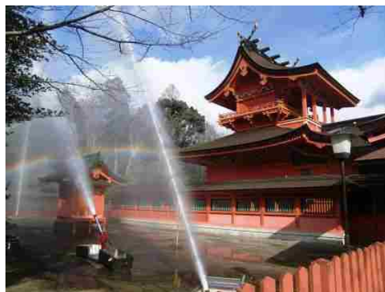
写真7 浅間大社消火設備の点検
