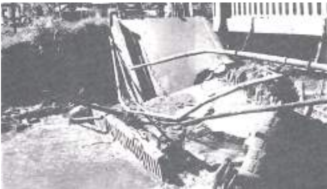
▲すさまじい泥流で落橋した野中橋
