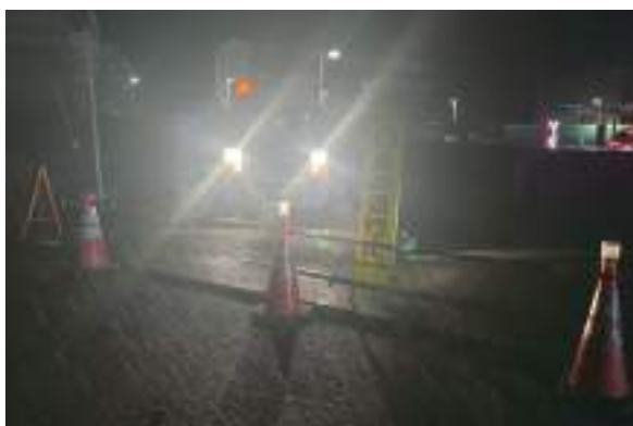
▲西消防署北側市道の陥没に伴う交通規制
