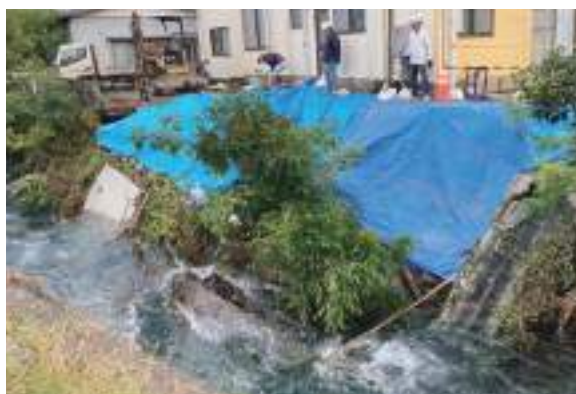
▲崩落した河川護岸の法面をシートで覆う(下川と潤井川の合流点付近)
