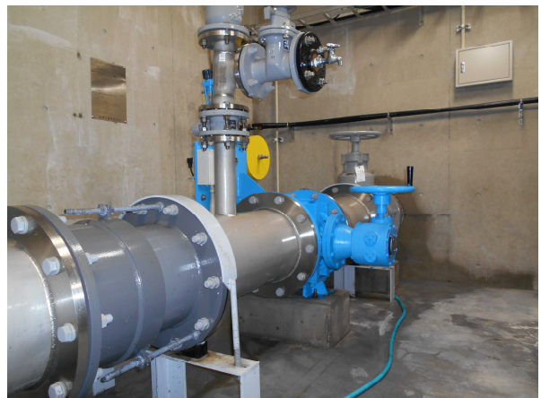
配水管設備（大宮配水池）
