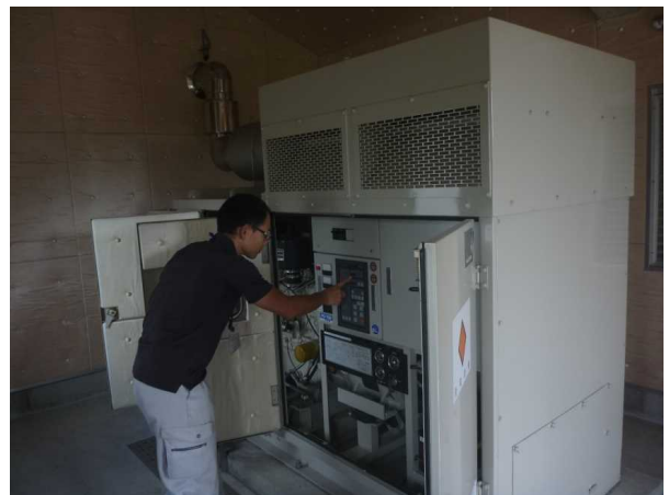
非常用自家発電設備の点検（北山浄水場）
