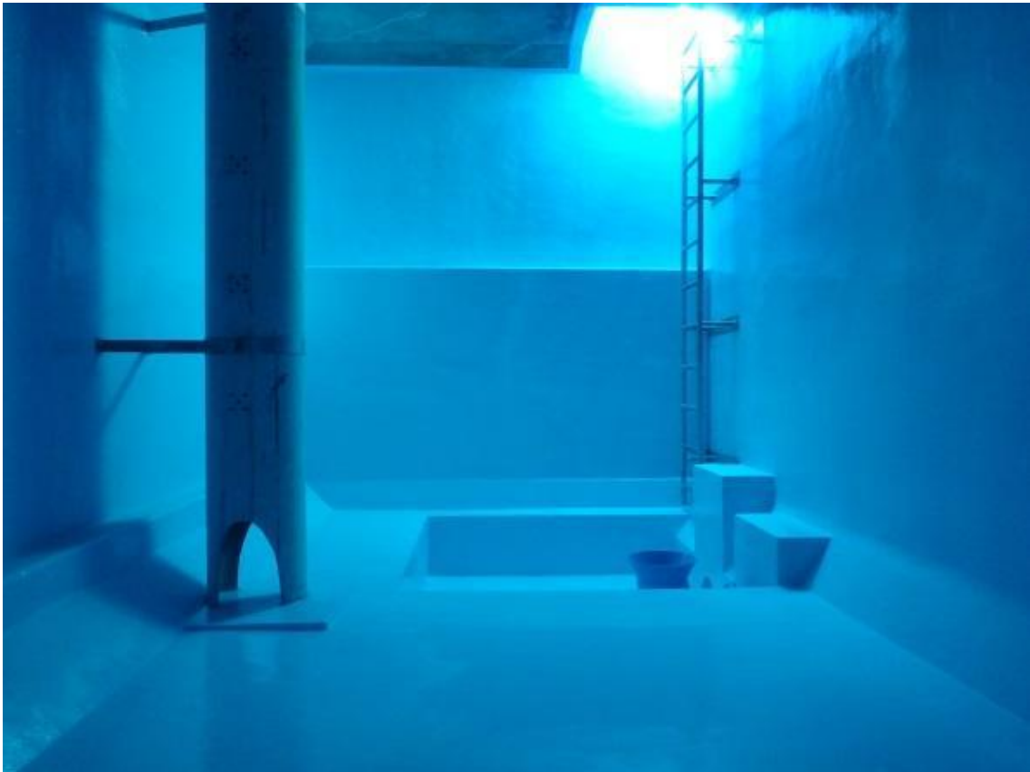
杉田第2配水池内の様子
