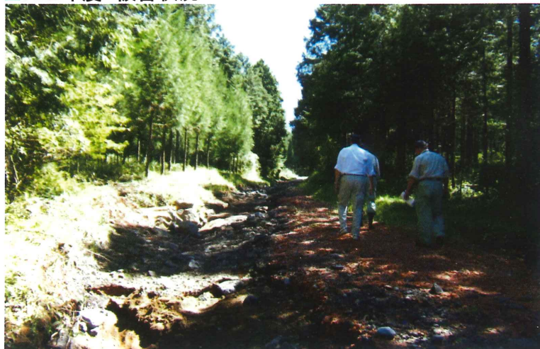
■ H25年度 被害状況
