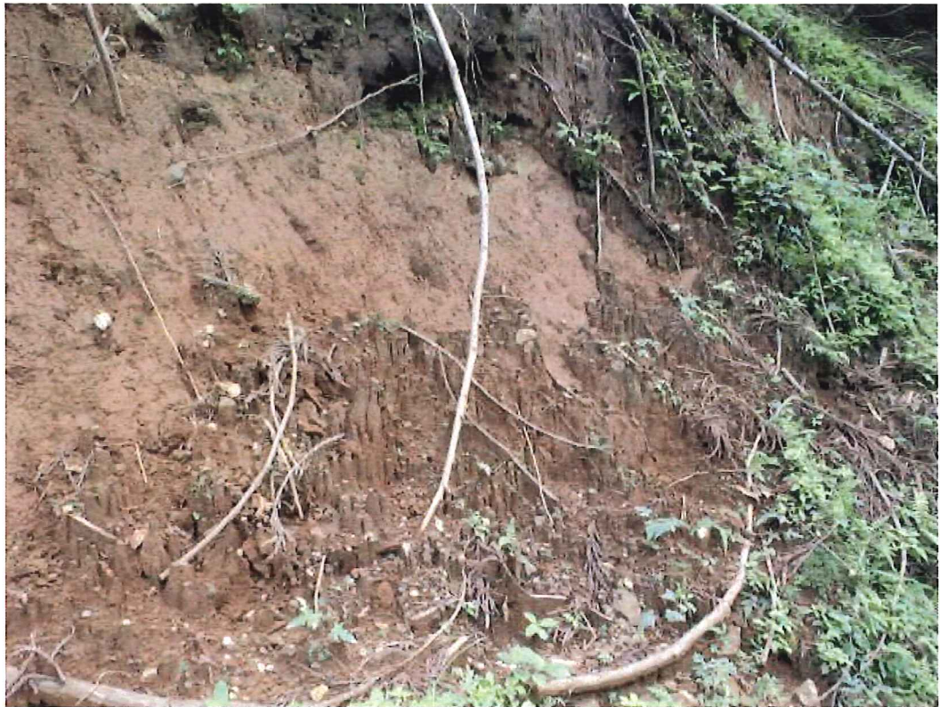
写真-32 新富士噴出物（ローム）の堆積；含水が高く保水性高い
