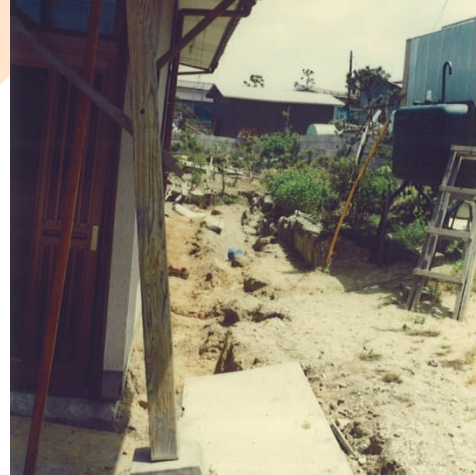
液状化による住宅の傾き
