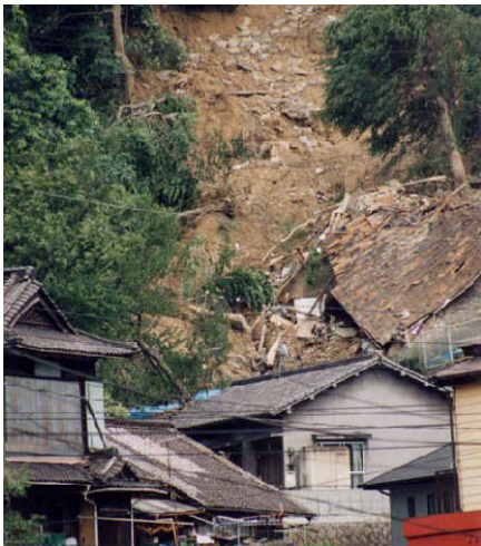
がけ崩れによる被害状況 出典：土砂災害ひろしまポータルサイト 「6.29豪雨災害写真集 がけ崩れ災害編」
