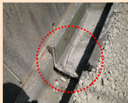
側溝の継目のずれ
