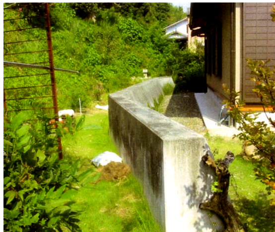
待ち受け擁壁の設置例
