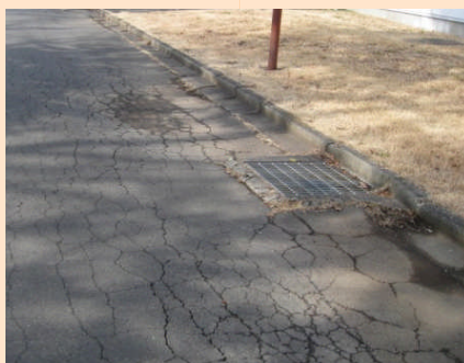
道路の沈下によるひび割れ
