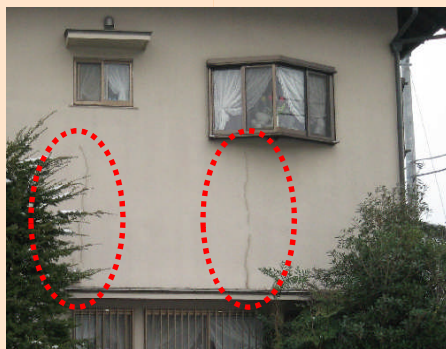
外壁のひび割れ
