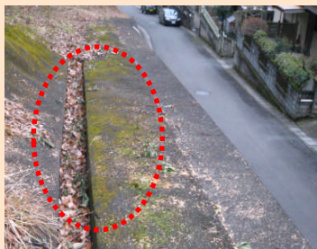
擁壁の上にある排水溝の詰まり
