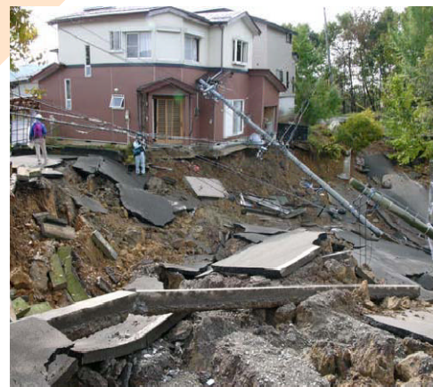
盛土の滑動崩落による宅地被害
