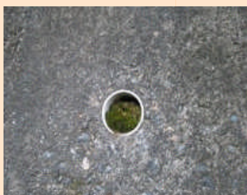
水抜き穴の詰まり
